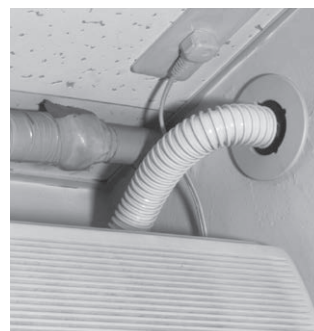
空調機まわりでの使用例
